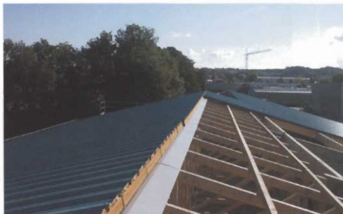
Bild 2. Die Dacheindeckung erfolgte mit grünen Ondatherm-1001 TS Paneelen mit verzinkten Deckschalen aus Stahl (Fotos: Alois Hundewick Industrie und Gewerbebau)
