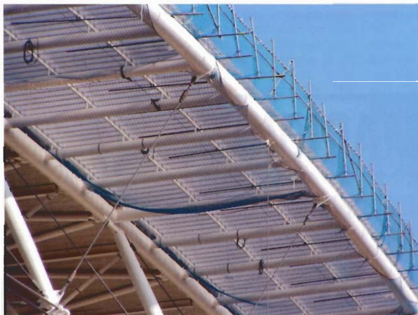
Das Tragwerk besteht aus zwei nach außen geneigten seilunterspannten Bogenbindern in Längsrichtung in Längsrichtung sowie Quer- und Längsträgern.
