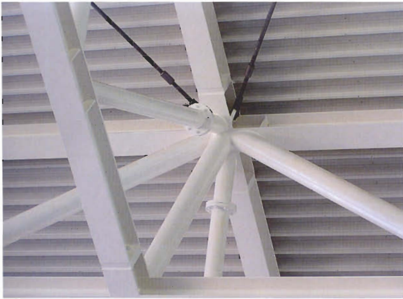
Leichtgewichtig: die ausgetüftelte Unterkonstruktion des Daches
