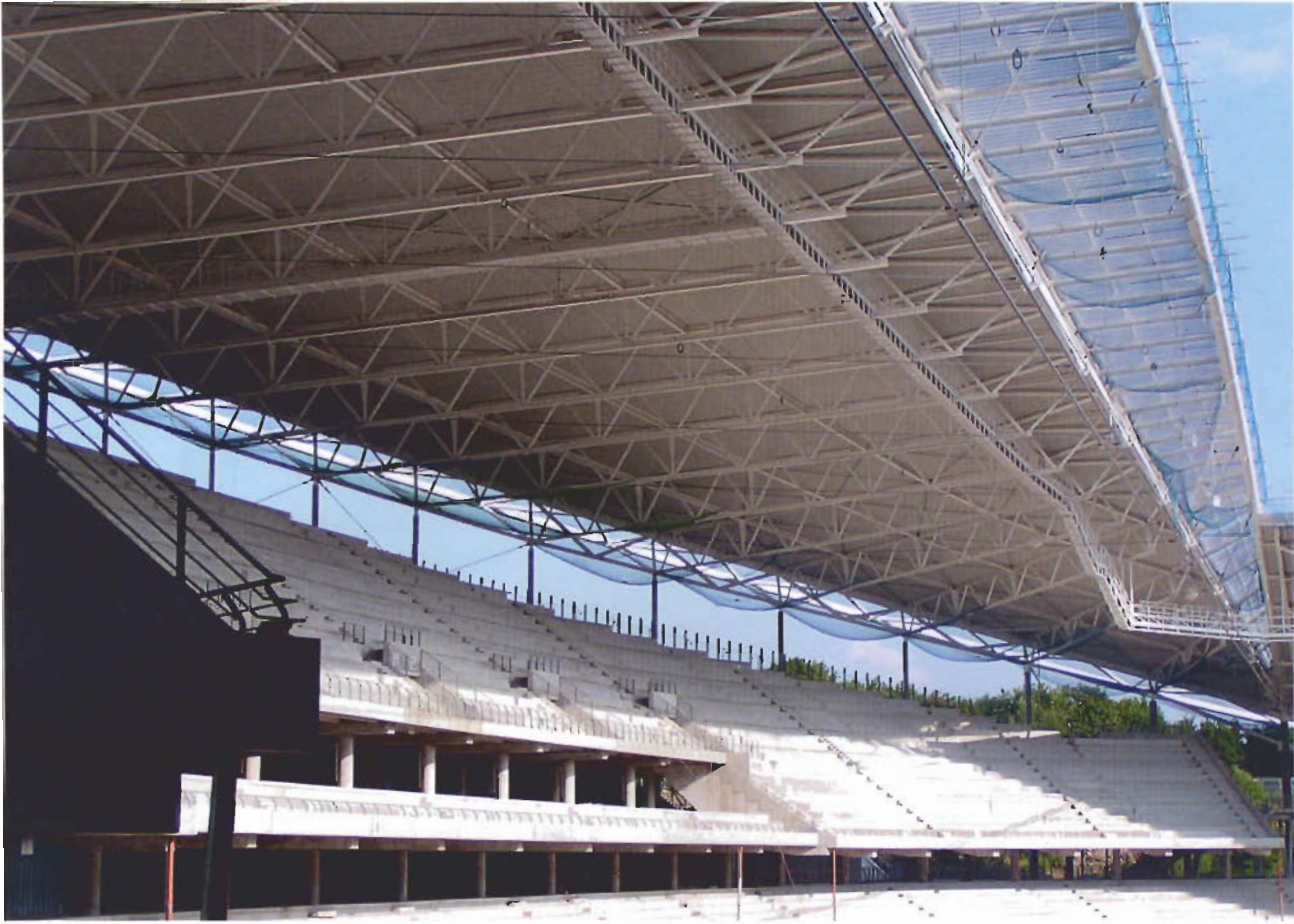
Überspannt die Tribünen stützenfrei: das geschwungene Dach mit seiner 17 m hohen Tragkonstruktion aus Stahl
