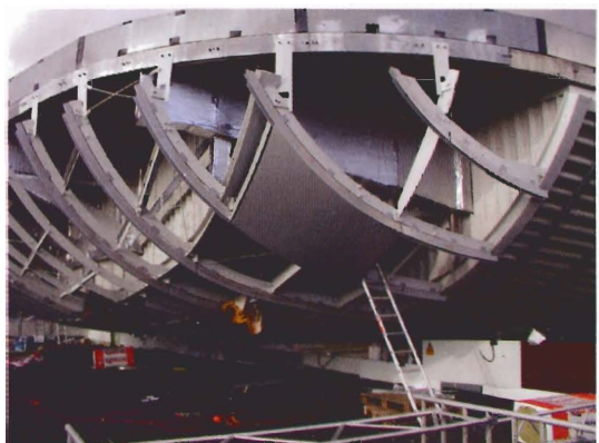
Bild 3. Das Tragwerk unter der Betonplatte besteht aus gebogenen Stahlbindern, die mit Trapezprofilen verkleidet werden
